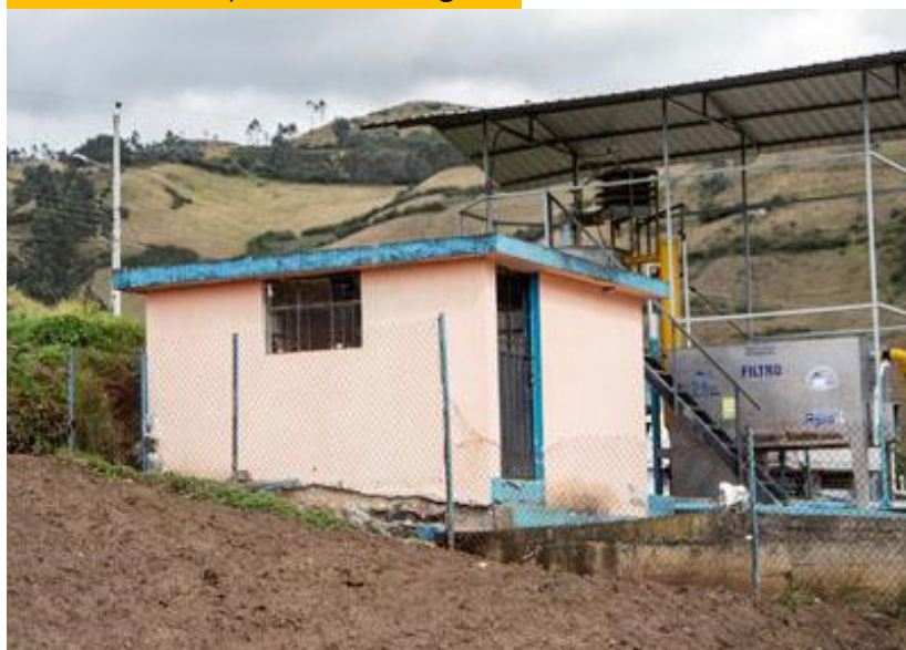
Fundación Prospecta. Punto de captación, tratamiento y distribución de agua de vertientes naturales. Cuzubamba, Cayambe. Ecuador, 2022.
